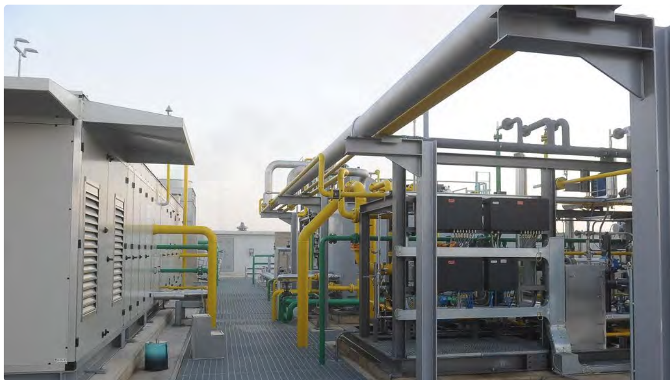
Un impianto biogas del territorio lodigiano
